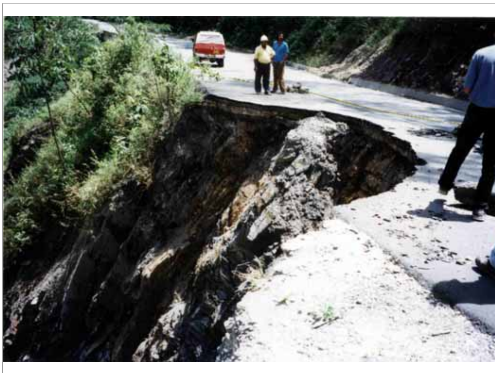
Foto 11. Derrumbe en el borde del talud frente a la estación G27. Lodolitas negras, laminadas, moderadamente meteorizadas, débiles.
