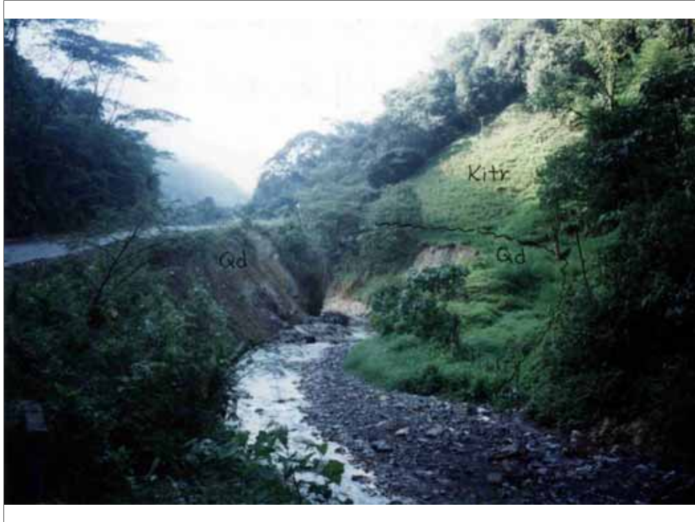
Foto 2. Valle de la Quebrada Aguasal y carretera Pacho-La Palma en la abcisa K 5 + 350. En febrero de 1994 durante la ampliación de la carretera, ocurrió un deslizamiento de coluviones de la ladera oriental (Qd) que represó la quebrada en este punto durante tres meses. Cuando la quebrada logro abrir paso en abril de 1994, se restableció el paso de la via, se amplió a dos calzadas y eventualmente se pavimentó. En la fotografía se aprecian los depósitos del deslizamiento de detritos (Qd), tanto del lado oriental como del lado occidental, sobre las lodolitas de la Formación Trincheras (Kitr).
