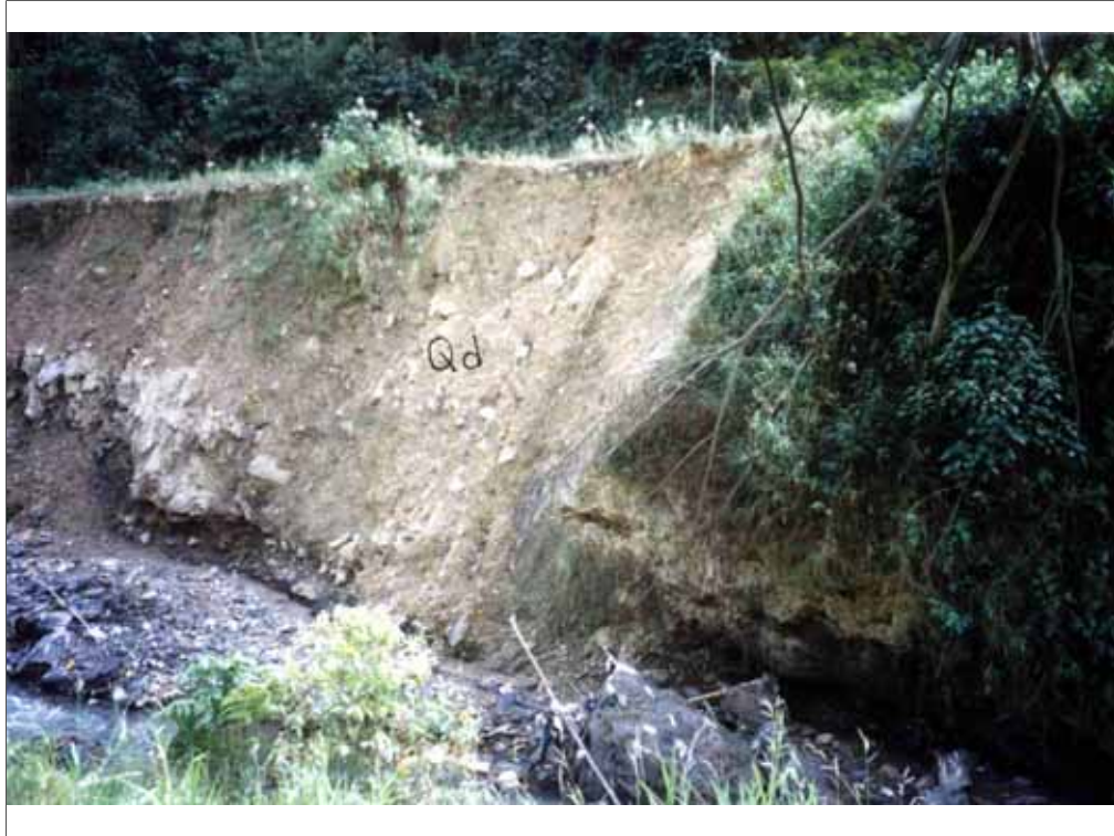
Foto 3. Estación G5. Trozos y bloques angulares de lodolita englobados en una matriz arcillosa (Qd).
