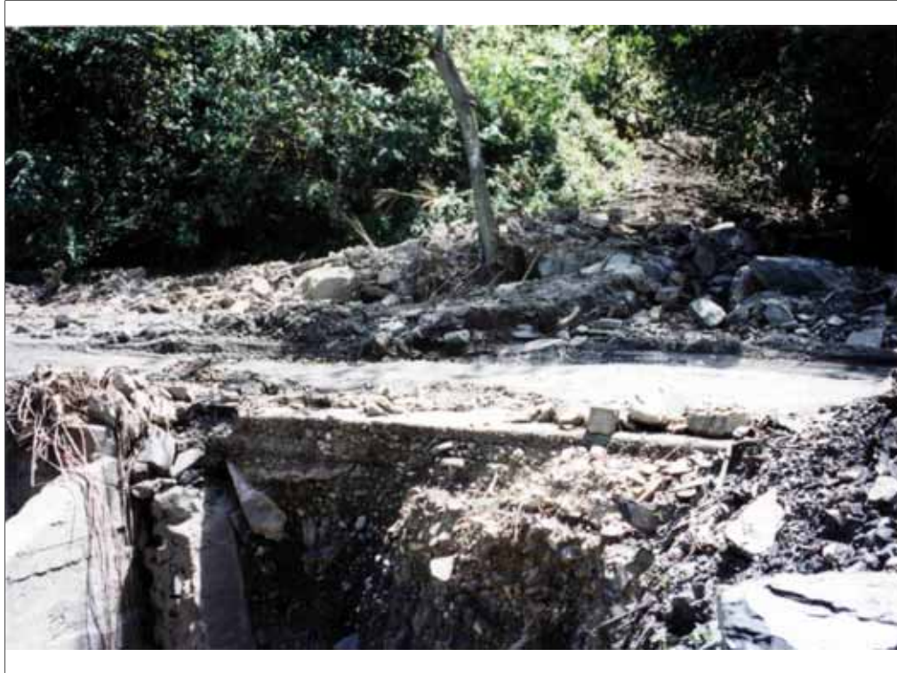
Foto 15. Flujo de detritos que colmató el box-culvert de la carretera en la abcisa K 5 + 950, durante la primera semana de junio de 1999.
