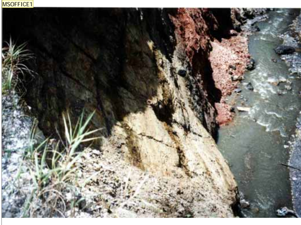
Foto 8. Socavación de la Quebrada Aguasal en la base del talud (G8) provocando el derrumbe de las lodolitas altamente meteorizadas sobre el plano de diaclasamiento 215/45^\circ (G8A).
