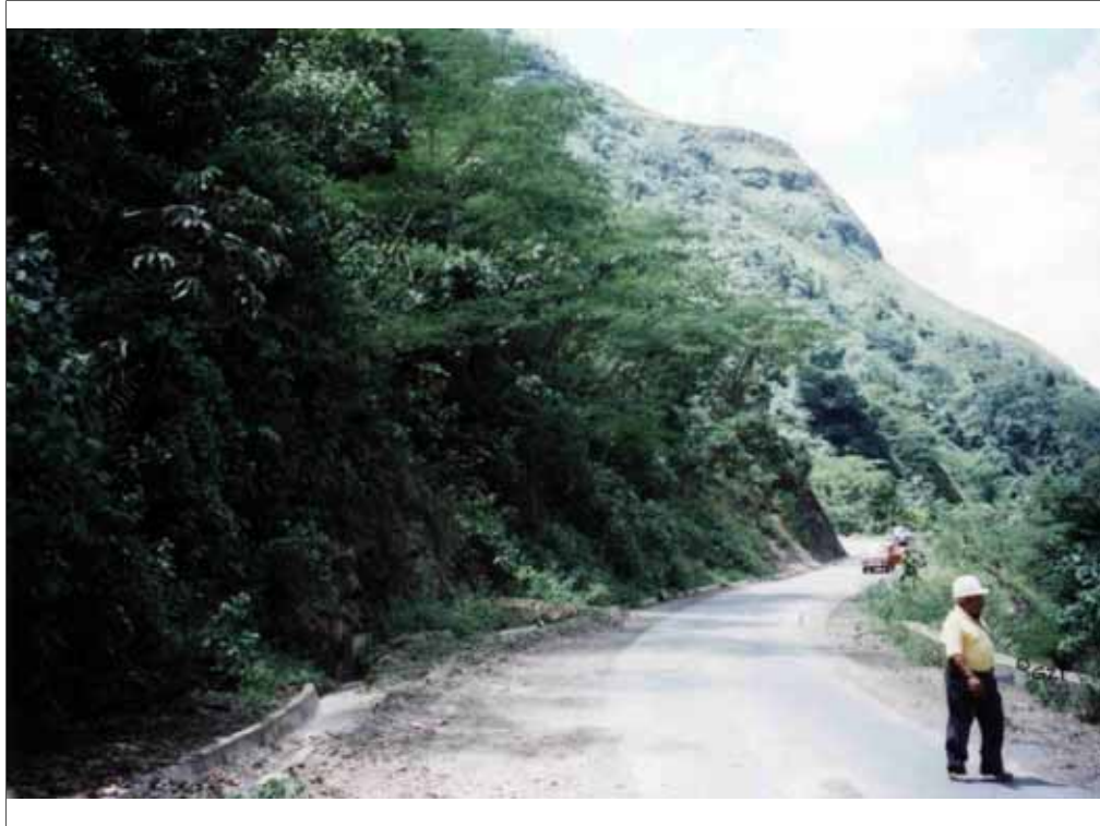
Foto 4. Carretera Pacho-La Palma entre las estaciones G22 y G21. Sector estable sobre lodolitas de la Formación Trincheras (Kitr). (Corte F-F').
