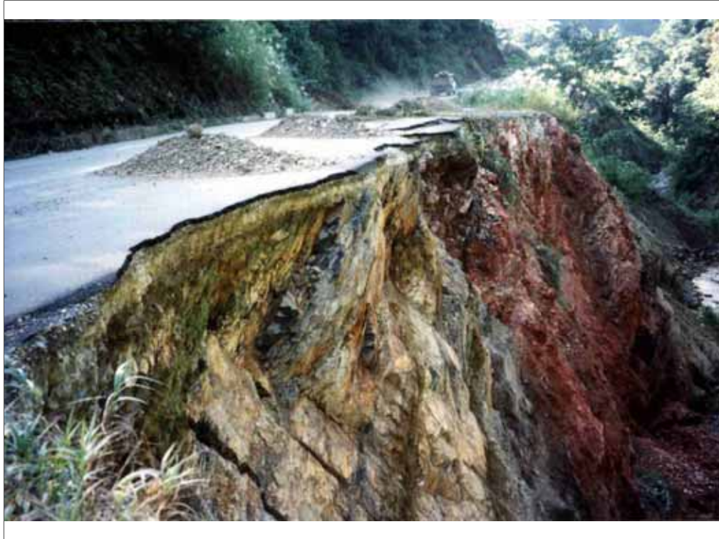
Foto 6. Derrumbes en el borde del talud de la carretera en la estación G8A. Lodolitas habanas, en estratos muy delgados, altamente meteorizadas, muy débiles (Kitr).
